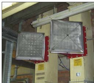
Rys. 2. ELEWATOR KUBEKOWY Z PANELEM BEZPIECZEŃSTWA ORAZ IZOLACJĄ CHEMICZNĄ CHRONIĄCĄ PRZED ROZPRZESTRZENIANIEM SIĘ WYBUCHÓW
